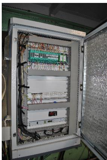
Рисунок 3 – Шкаф температурных преобразователей
