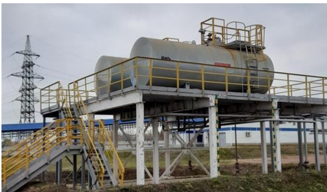
Рисунок 2 – Общий вид резервуаров РГС-20 (17+3)
