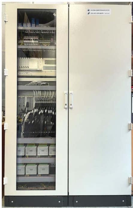
Рисунок 1 - Шкаф измерительного оборудования
