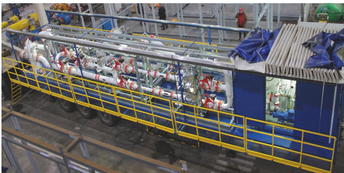
Рисунок 1 – Общий вид установки
