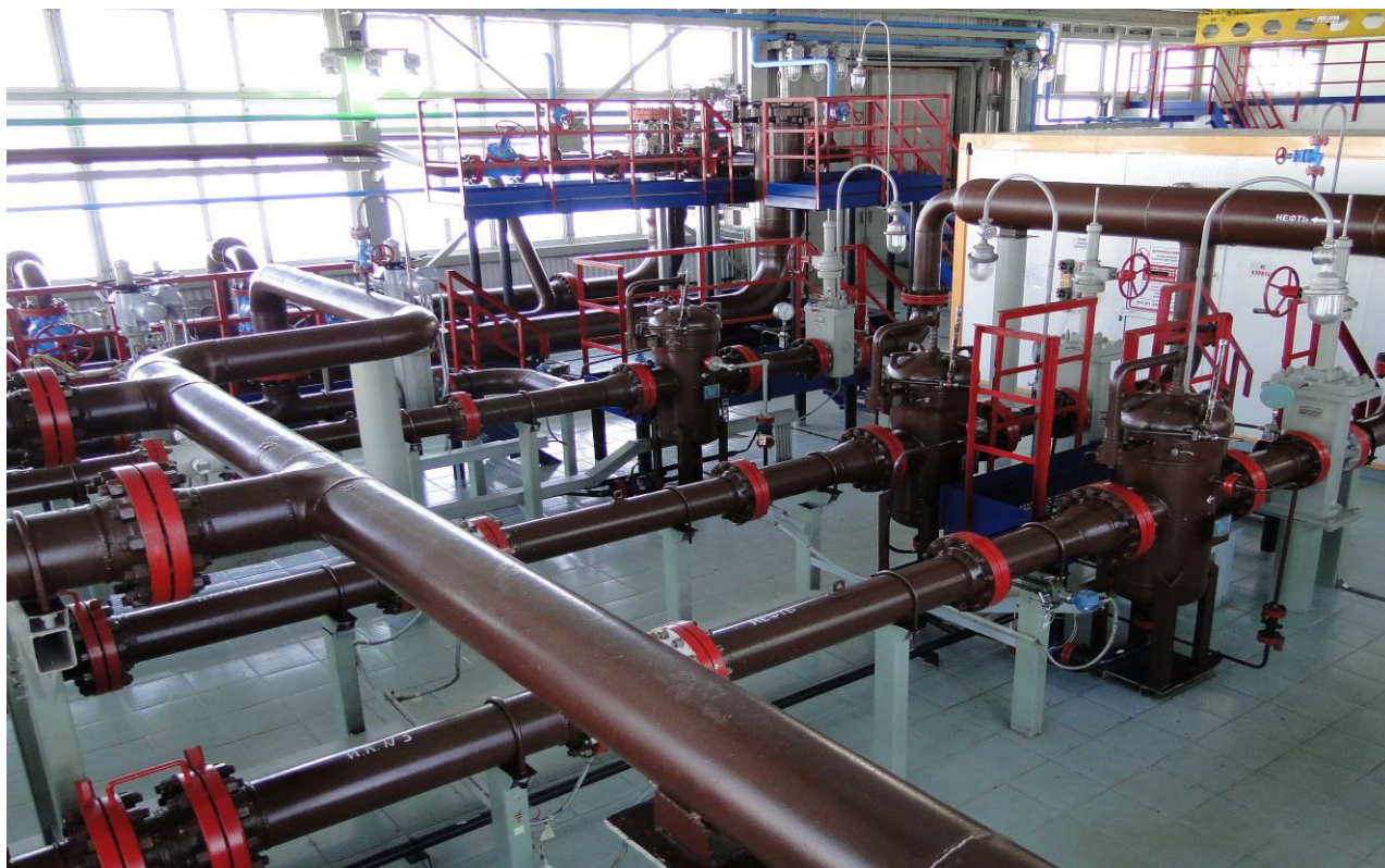
Рисунок 1 – Общий вид СИКН
