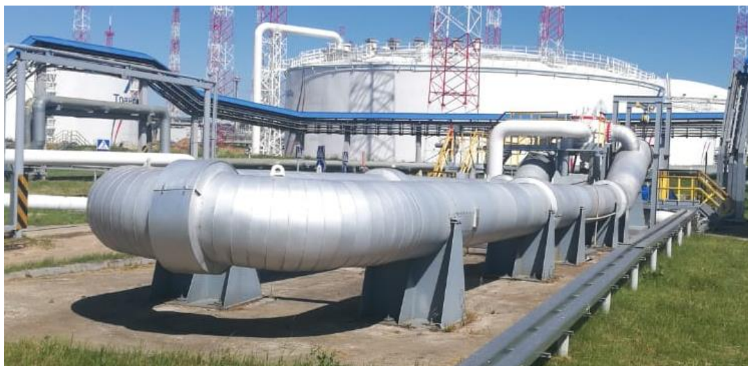
Рисунок 1 – Общий вид установки поверочной трубопоршневой двунаправленной
