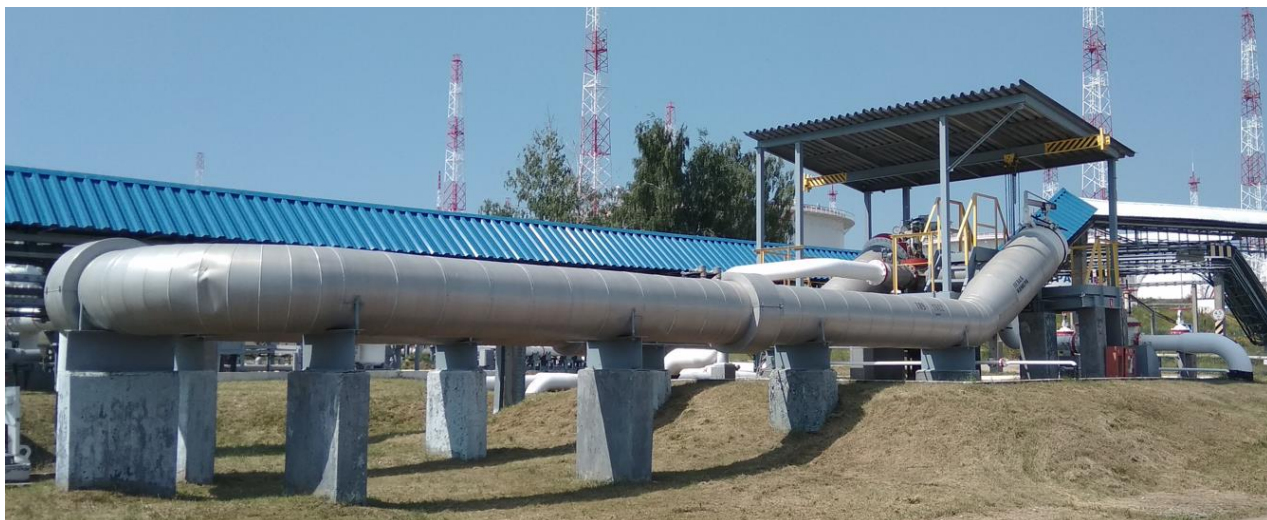
Рисунок 1 – Общий вид установки поверочной трубопоршневой двунаправленной
