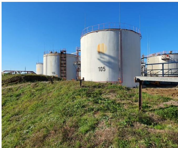
Рисунок 1 – Общий вид резервуаров с зав. №№ 105 и 106
