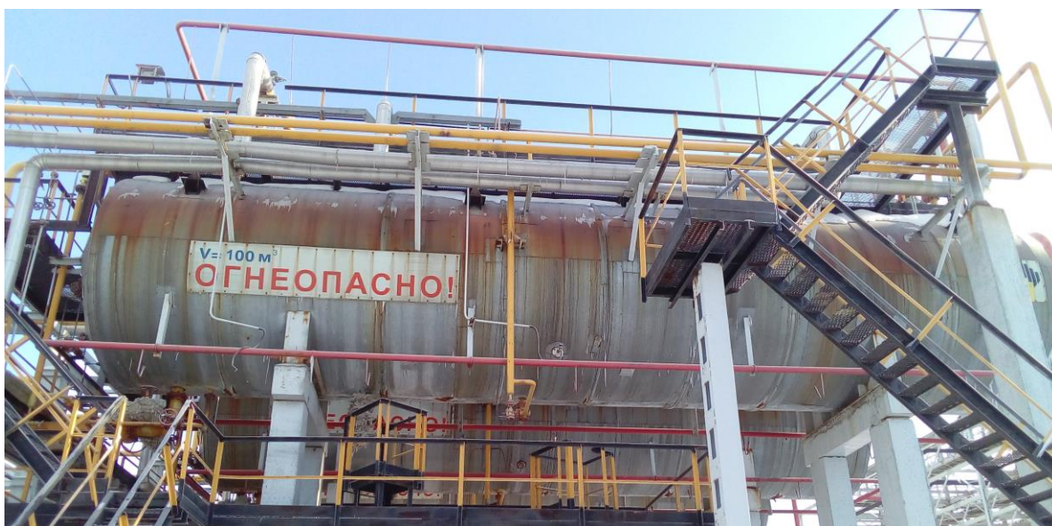
Рисунок 1 – Общий вид резервуаров РГС-100
