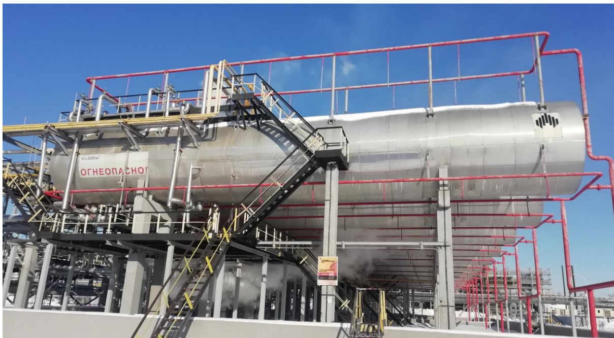
Рисунок 2 – Общий вид резервуаров РГС-200
