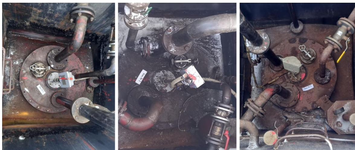
Рисунок 1 – Общий вид резервуаров РГС-25
