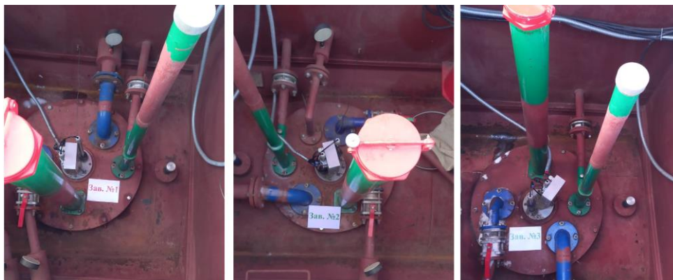
Рисунок 1 – Общий вид резервуаров РГС-25
