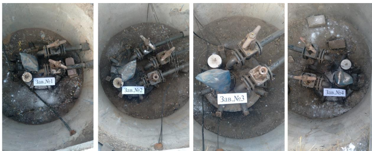
Рисунок 1 – Общий вид резервуаров РГС-60
