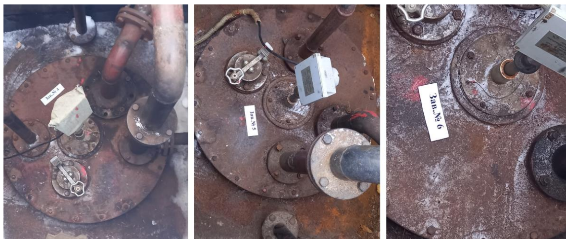
Рисунок 2 – Общий вид резервуаров РГС-25
