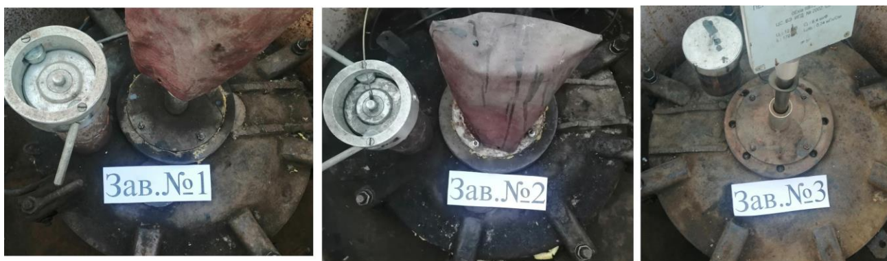
Рисунок 1 – Общий вид резервуаров РГС-60
