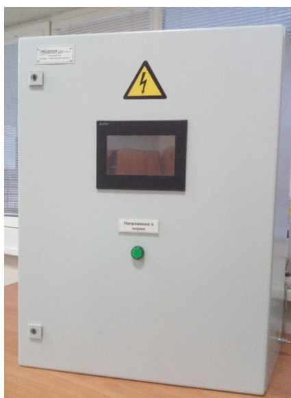
Рисунок 2 - Внешний вид шкафа управления
