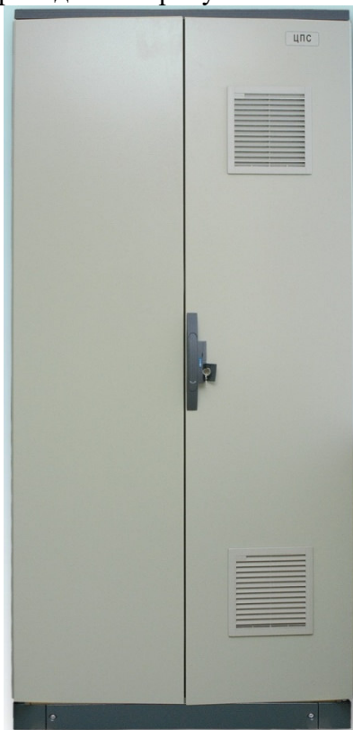
Рисунок 1 - Внешний вид приборного шкафа комплекса
