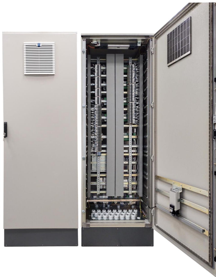
Рисунок 4 - Общий вид шкафа № 2 сзади
