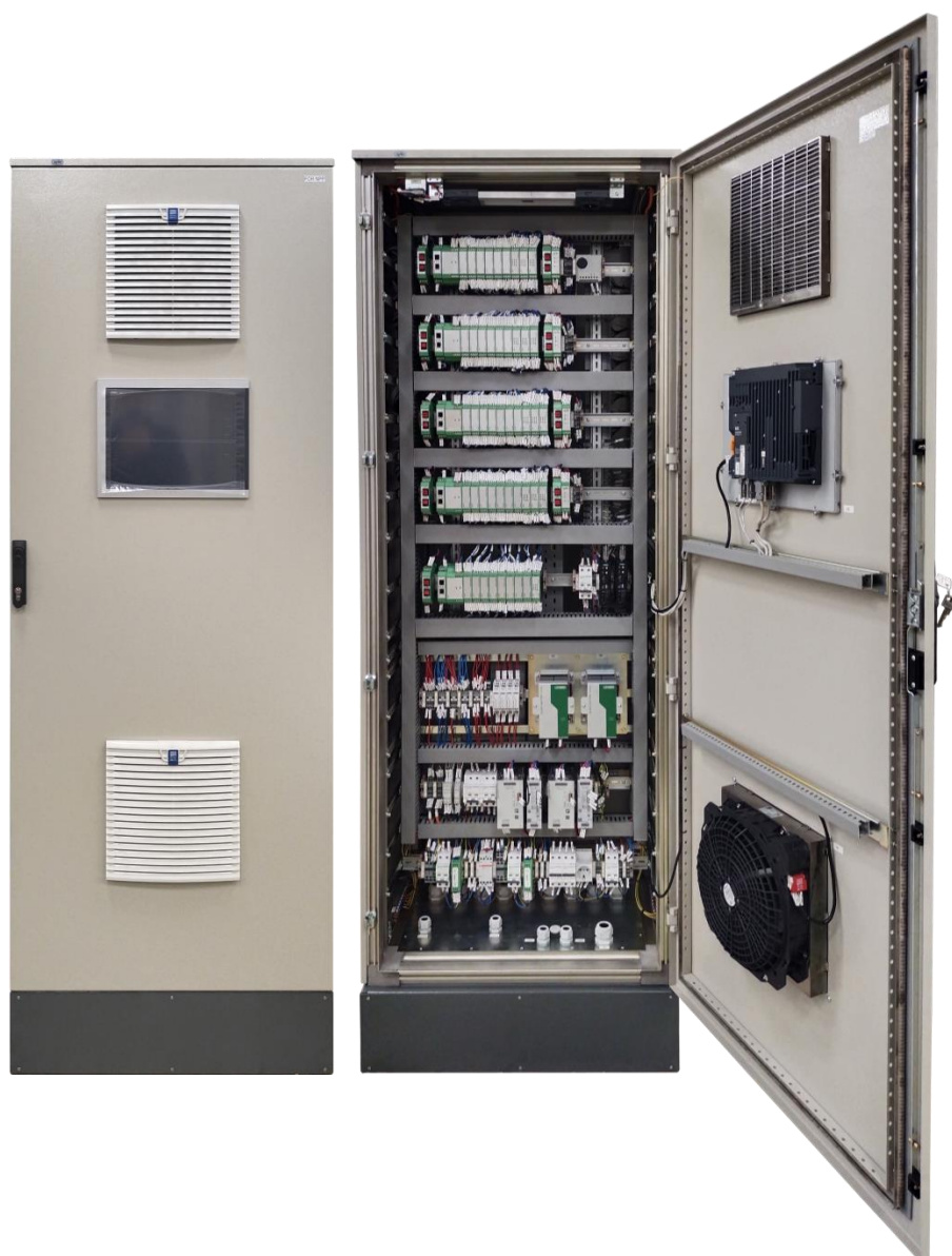
Рисунок 3 - Общий вид шкафа № 2 спереди
