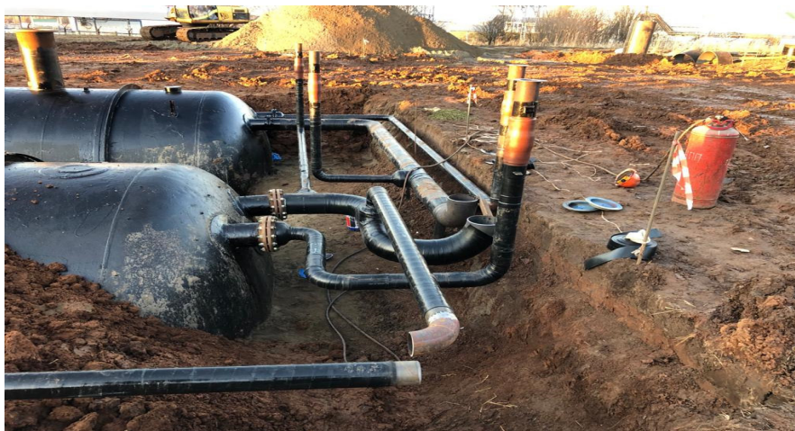
Рисунок 2 – Общий вид резервуаров стальных горизонтальных цилиндрических РГС-100
