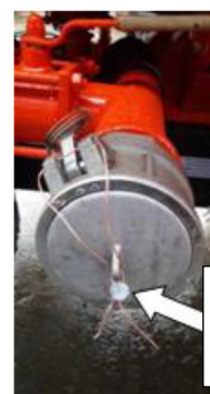
б) трубопровод слива-налива
