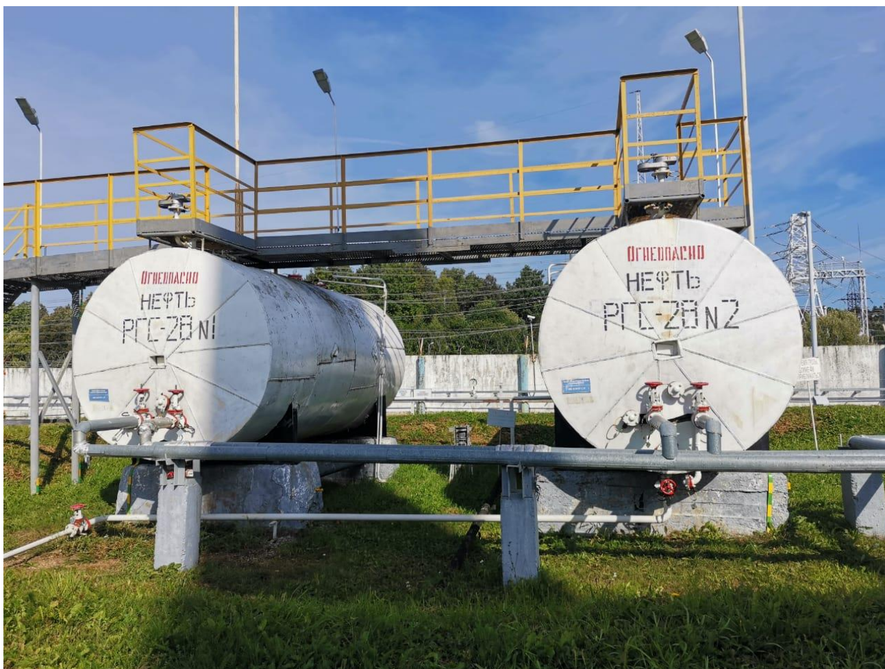
Рисунок 1 – Общий вид резервуаров РГС-28
