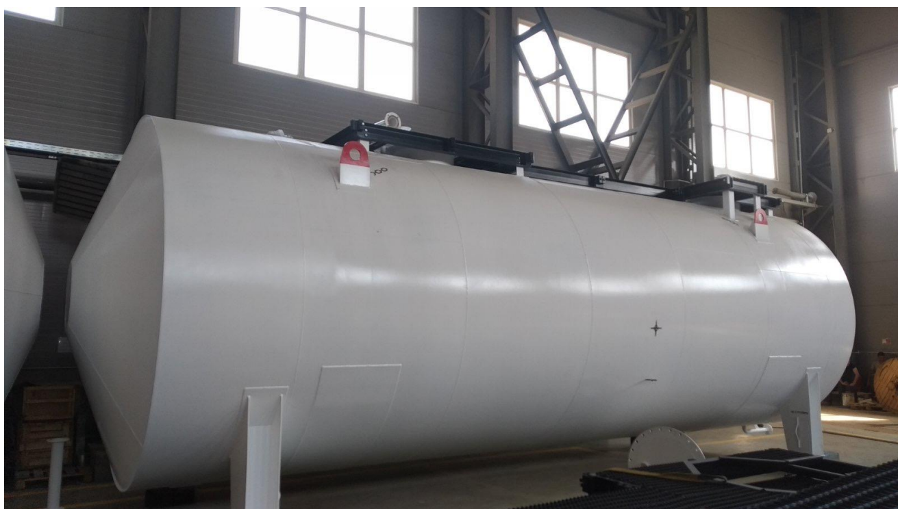
Рисунок 2 – Общий вид резервуаров РГСн
