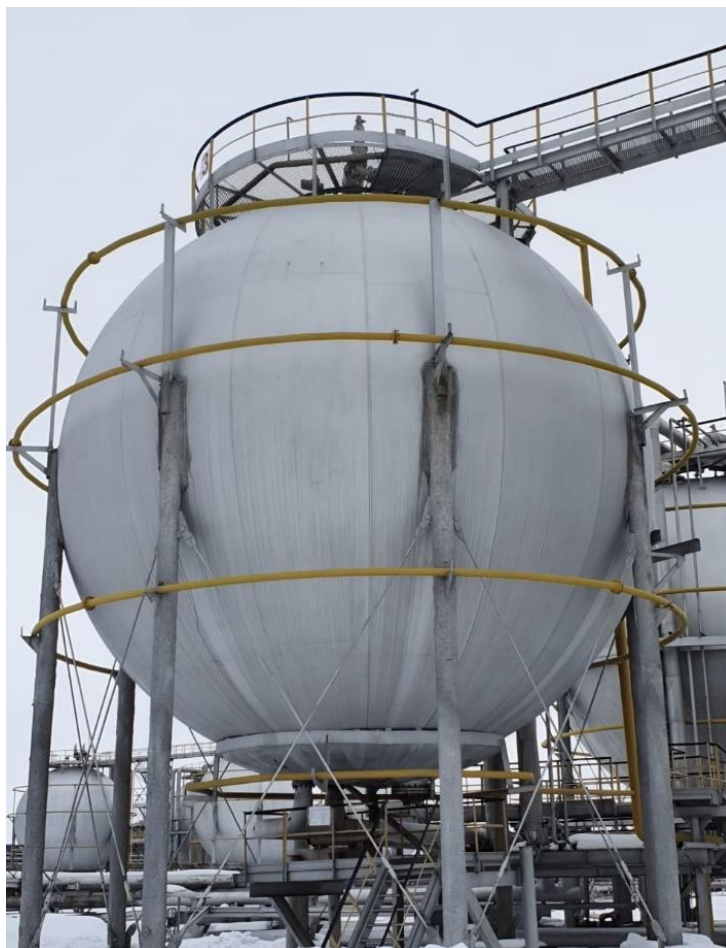
Рисунок 1 – Общий вид резервуаров РШС-600
