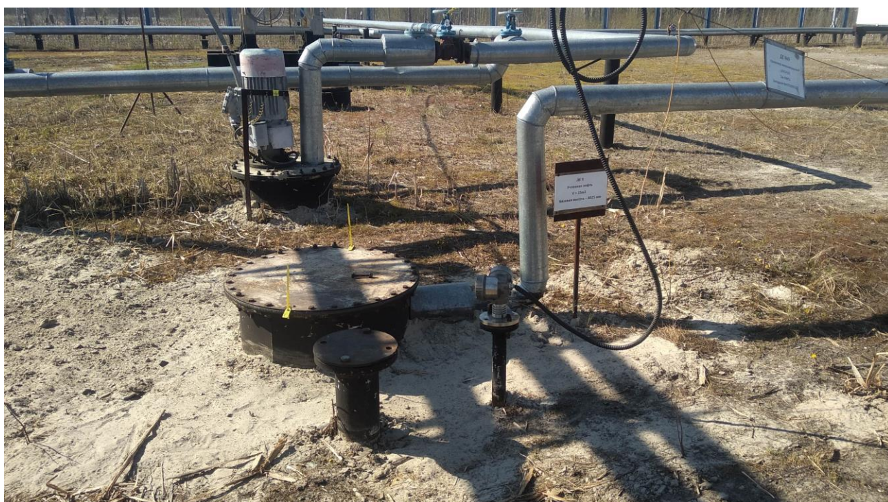
Рисунок 2 – Общий вид резервуара ЕП-25-2400-1-3
