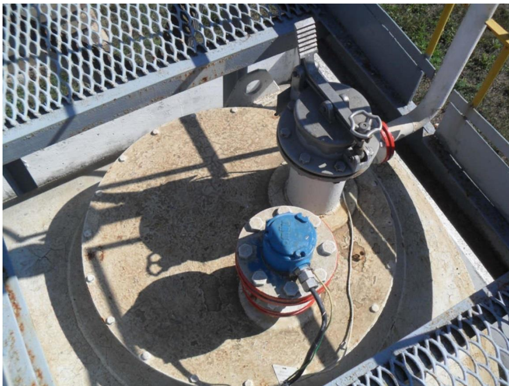
Рисунок 4 – Общий вид резервуаров РГС-5
