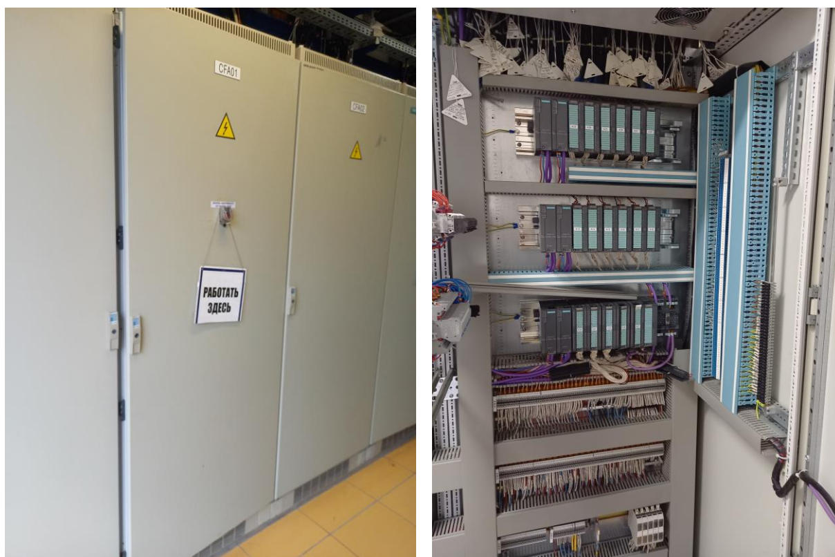
Рисунок 1 – Внешний вид контроллерного шкафа
