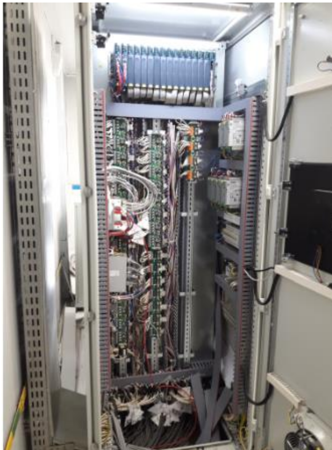
Рисунок 1 – Общий вид электротехнического шкафа системы
