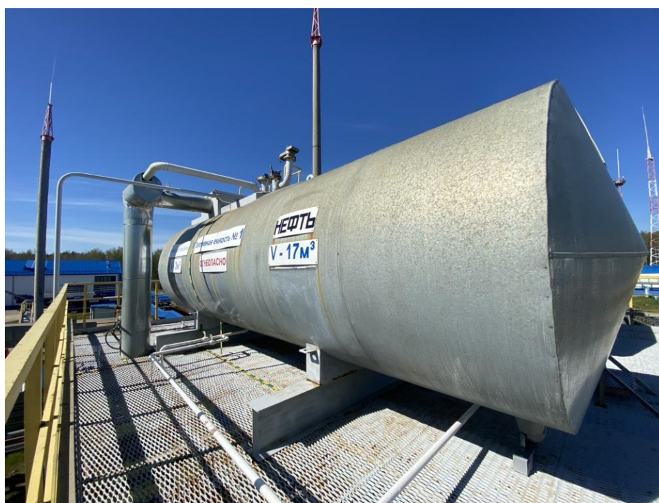
Рисунок 2 – Общий вид РГС-20 с заводским номером 208
