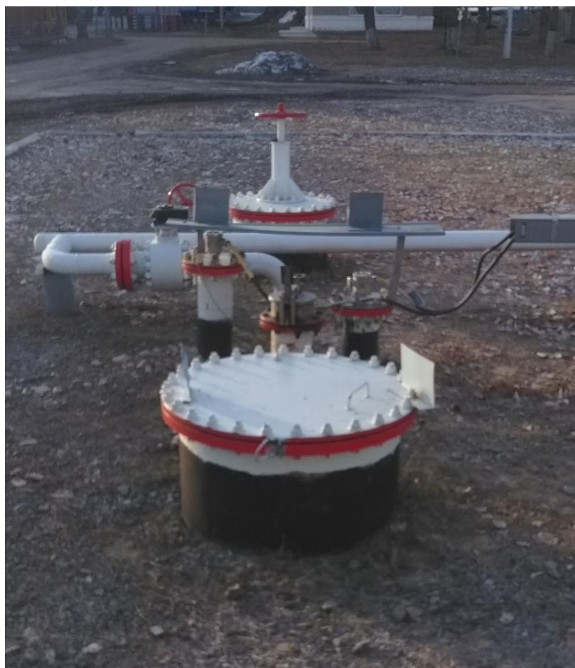
Рисунок 1 – Общий вид резервуаров РГС-100
