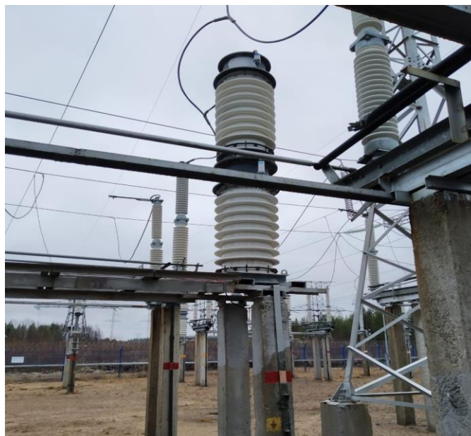
Рисунок 1 – Общий вид трансформаторов
