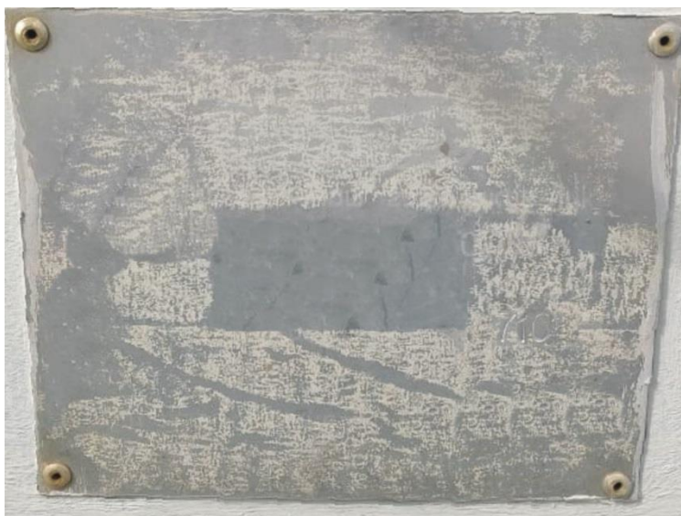
Рисунок 22 – Маркировочная табличка резервуара РГС-20 зав.№ 710
