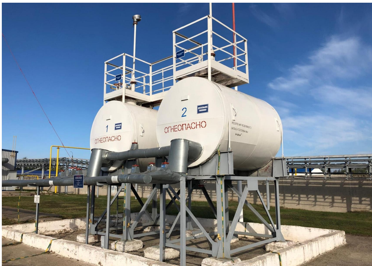
Рисунок 2 – Общий вид резервуаров РГС-10
