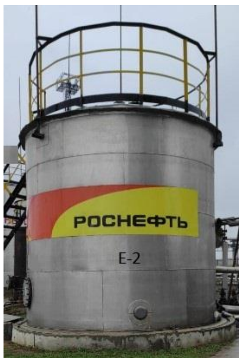
Рисунок 2 – Общий вид РВС-50 с заводским номером E-2
