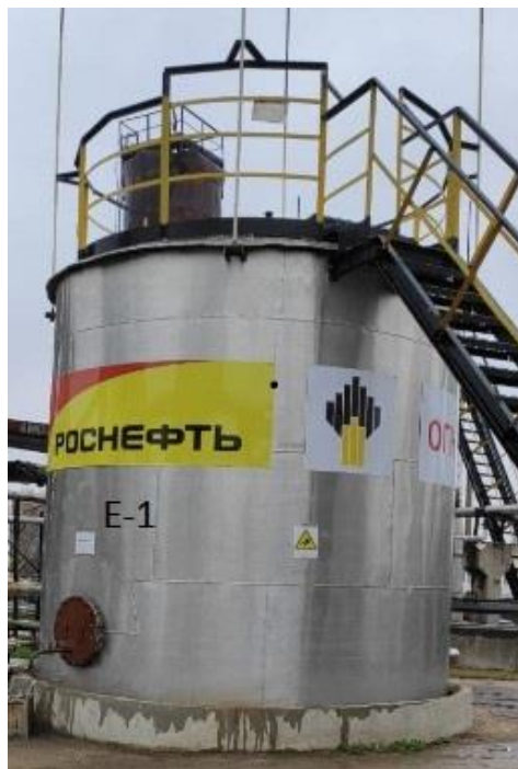
Рисунок 1 – Общий вид РВС-50 с заводским номером E-1
