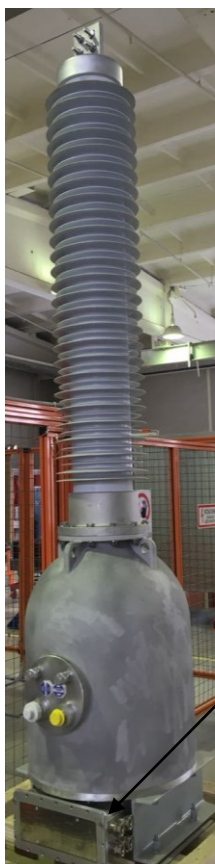
Рисунок 1 - Общий вид трансформаторов
