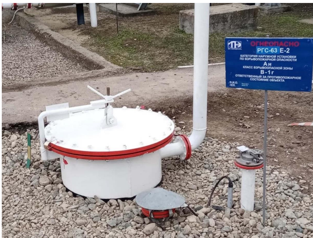
Рисунок 1 – Общий вид резервуаров РГС-63
