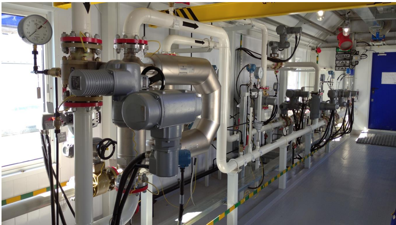
Рисунок 1 – Общий вид СИКН
