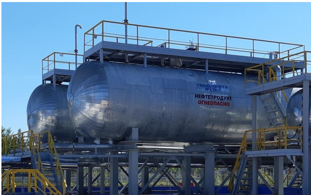
Рисунок 1 – Общий вид резервуаров РГС-100
