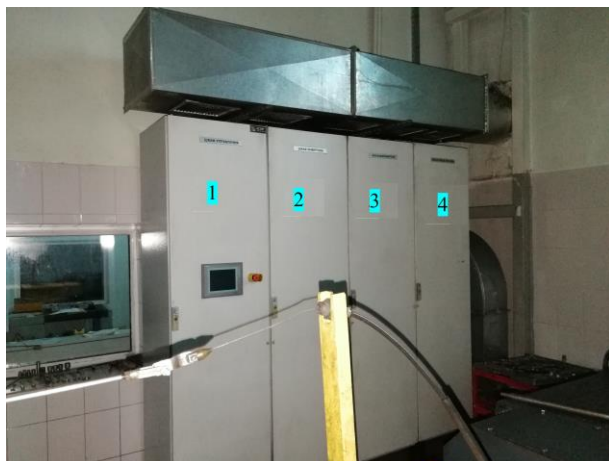
Рисунок 1 – Шкафы комплекса (1 – шкаф автоматического управления комплекса, 2 – шкаф инвертора, 3 – шкаф выпрямителя, 4 – шкаф ввода питания)
