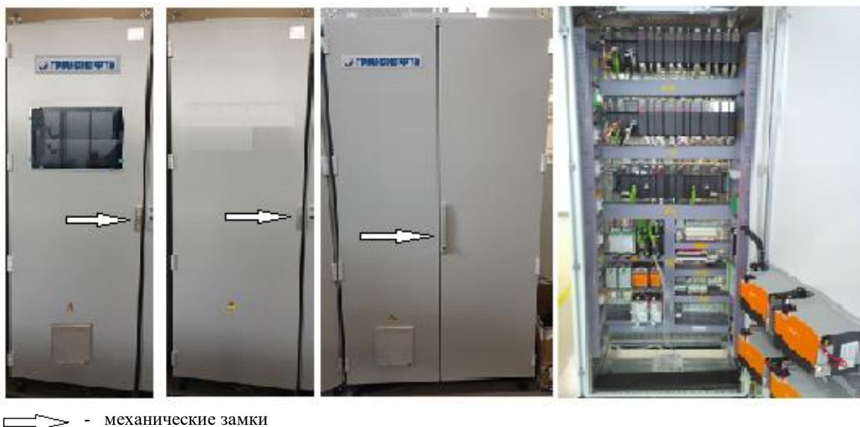
Рисунок 1 – Общий вид шкафа ПТК
