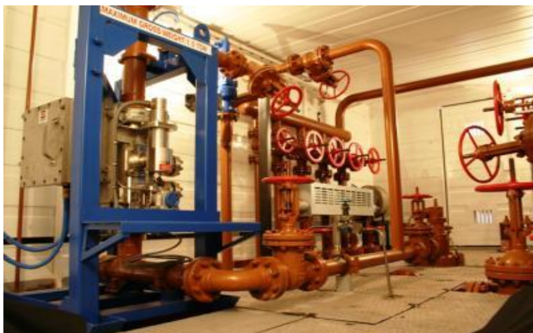
Рисунок 1 - Общий вид установки
