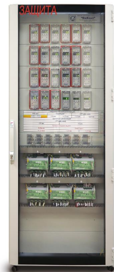
Рисунок 1 – Общий вид стойки управления
