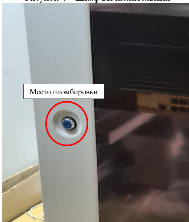
Рисунок 5 – Замок шкафа вычислительного
