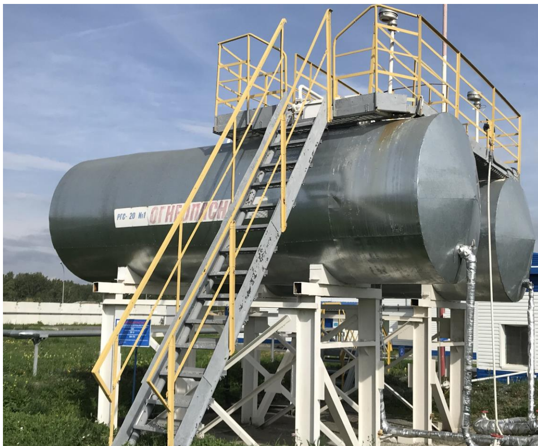
Рисунок 2 – Общий вид резервуаров РГС-20
