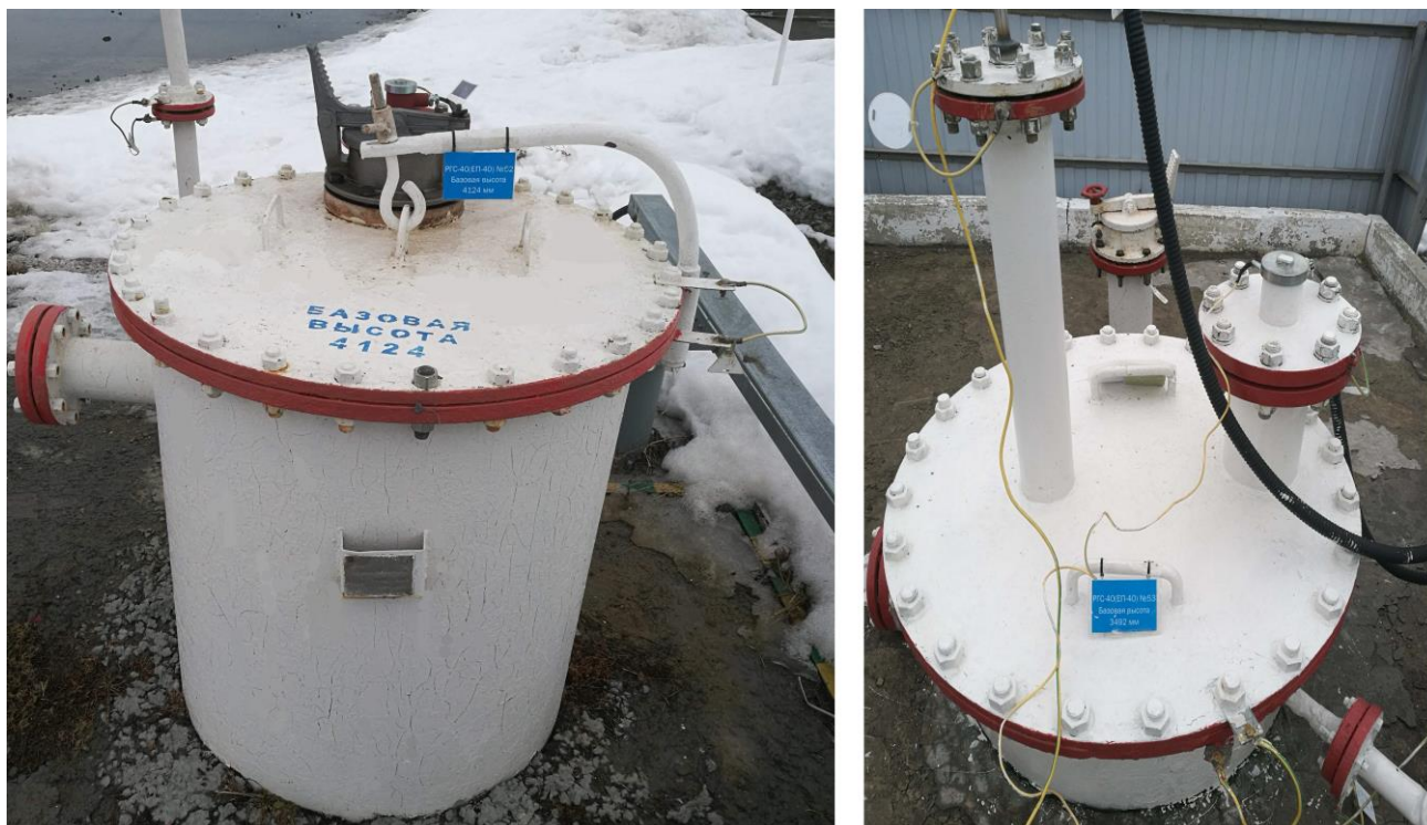
Рисунок 2 – Общий вид резервуаров РГС-40
