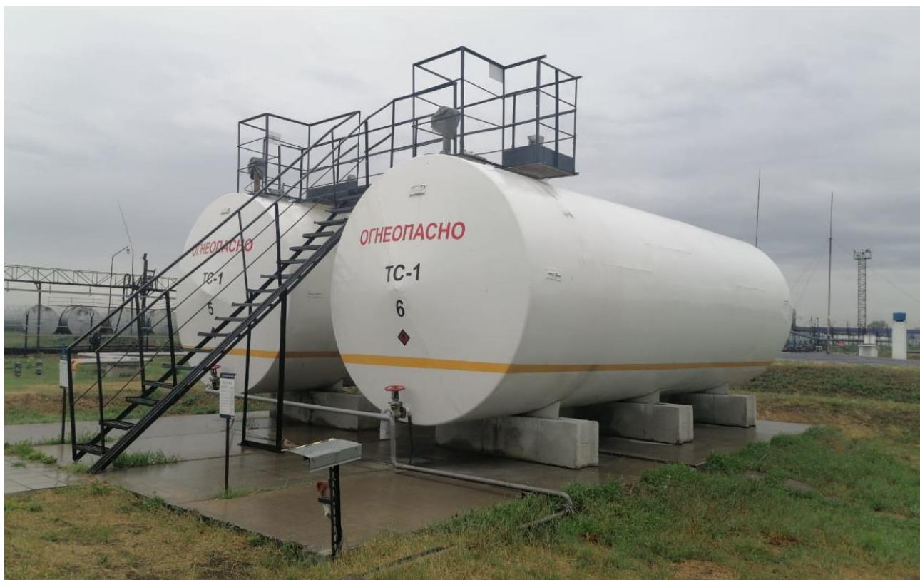
Рисунок 1 – Общий вид резервуаров РГС-75
