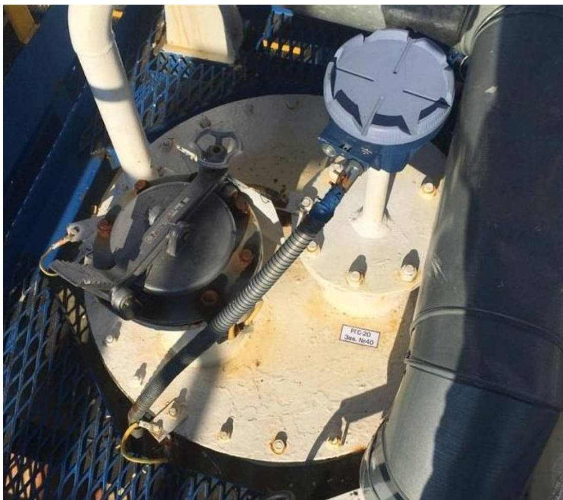
Рисунок 3 – Общий вид резервуаров РГС-20, зав.№40
