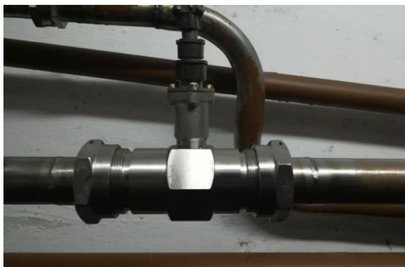
Рисунок 11 – Турбинный преобразователь расхода ТПР14-2-1. Монтаж по месту
