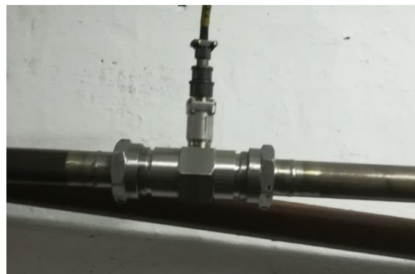
Рисунок 12 – Турбинный преобразователь расхода ТПР11-1-1. Монтаж по месту
