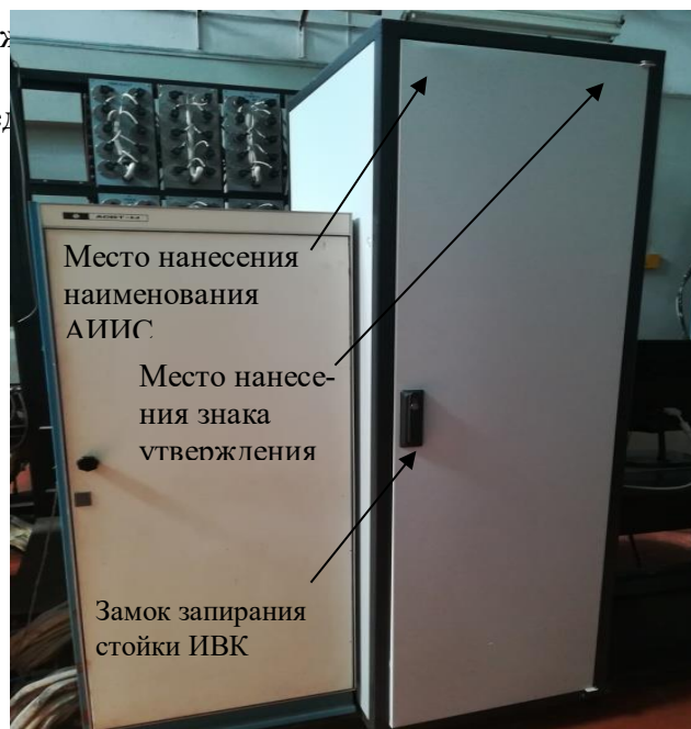
Рисунок 2 – Стойка ИВК (справа), вид с лицевой стороны
