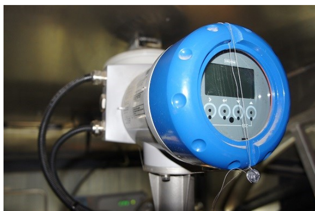
Рисунок 9 – Пломбирование расходомера-счетчика массового
