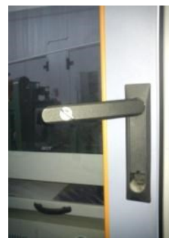
Рисунок 21 – Внешний вид замка на двери стойки управления
