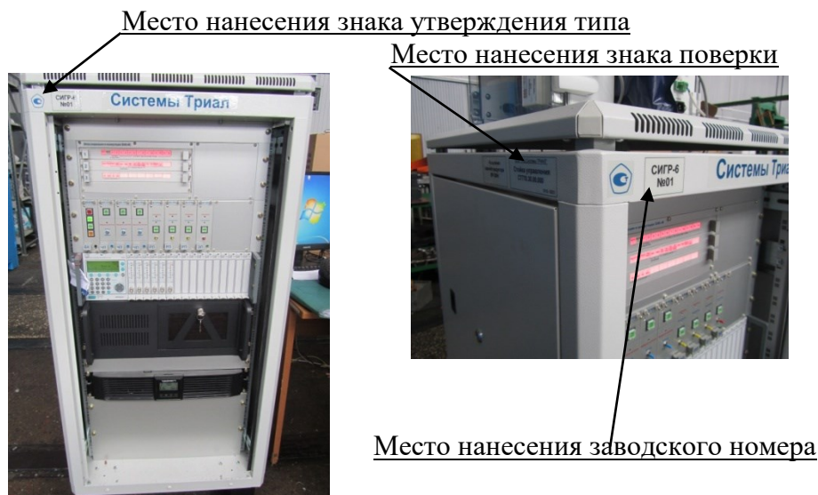
Рисунок 1 – Общий вид стойки управления
