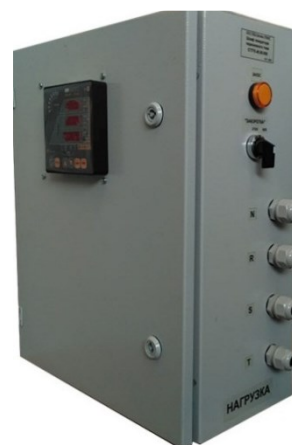
Рисунок 2 – Шкаф генератора переменного тока
