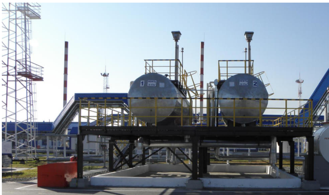
Рисунок 1 – Общий вид резервуаров стальных горизонтальных цилиндрических РГС-20
