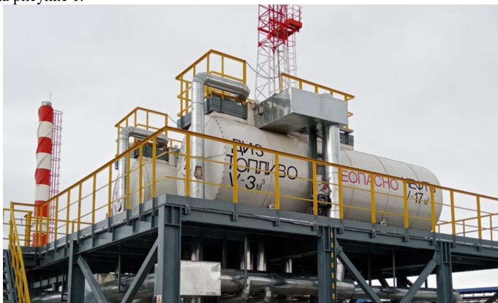
Рисунок 1 – Общий вид резервуаров РГС-20
