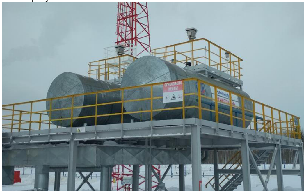
Рисунок 1 – Общий вид резервуаров РГС-20
