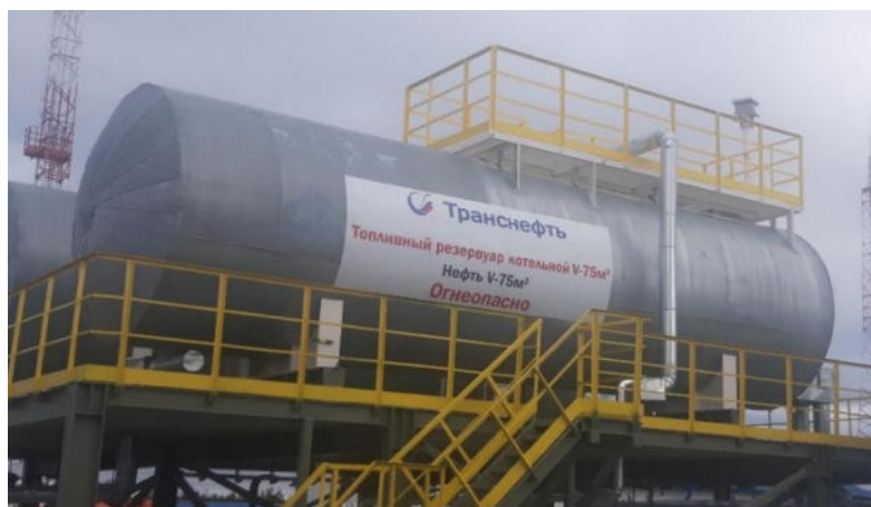
Рисунок 1 – Общий вид резервуаров РГС-75
