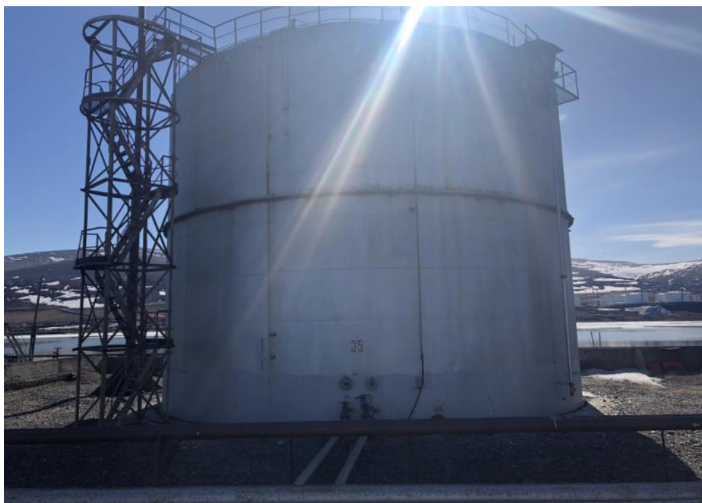
Рисунок 1. Общий вид резервуаров РВС-1000, РВС-3000, РВС-5000
