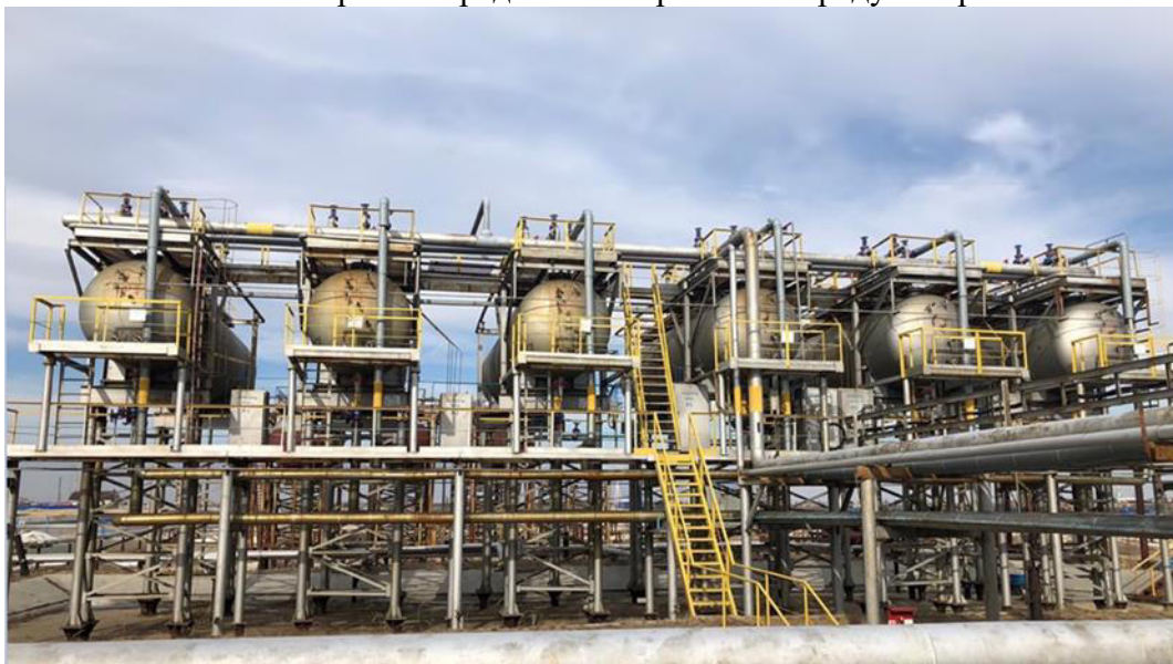
Рисунок 1 – Общий вид резервуаров РГС-50
