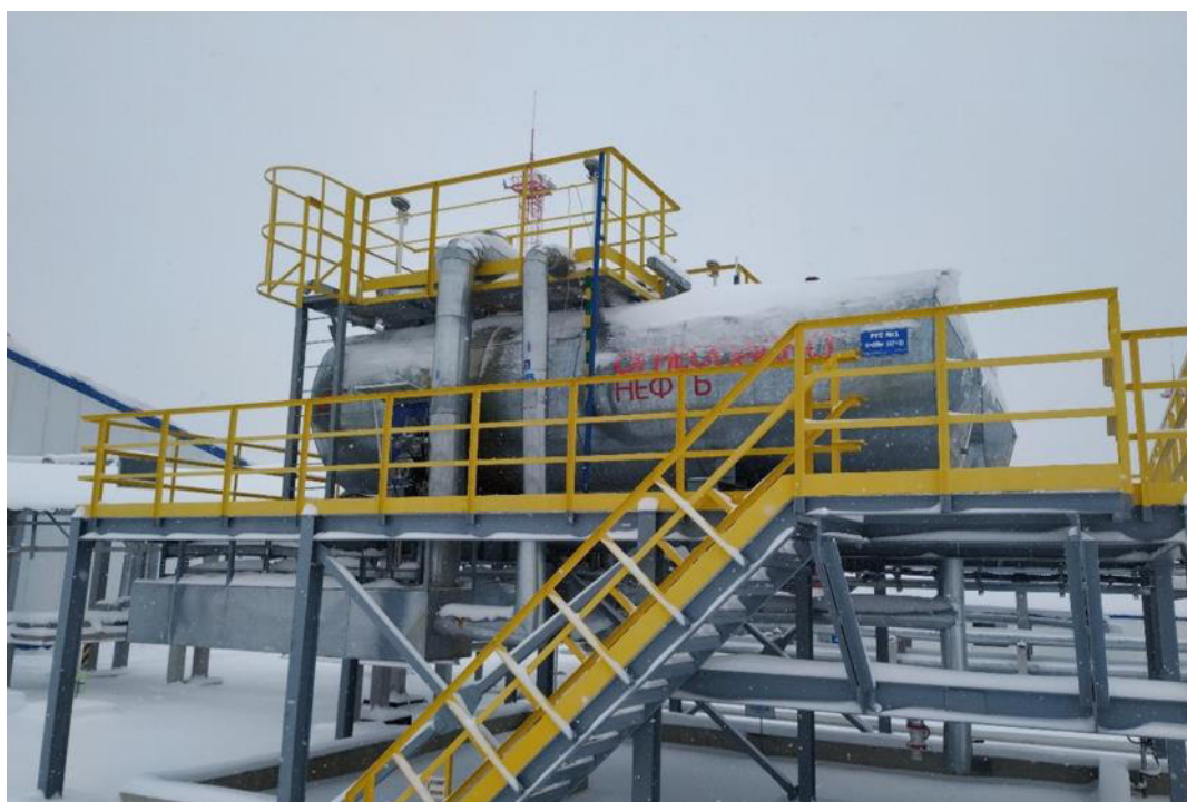
Рисунок 1 – Общий вид резервуаров РГС-20
