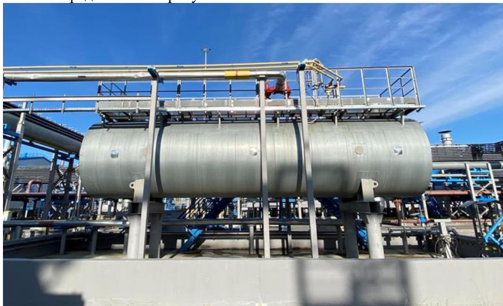
Рисунок 1 – Общий вид резервуаров РГС-50
