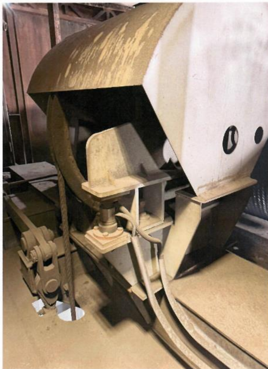
Рисунок 2 – Общий вид места встройки весоизмерительного датчика
