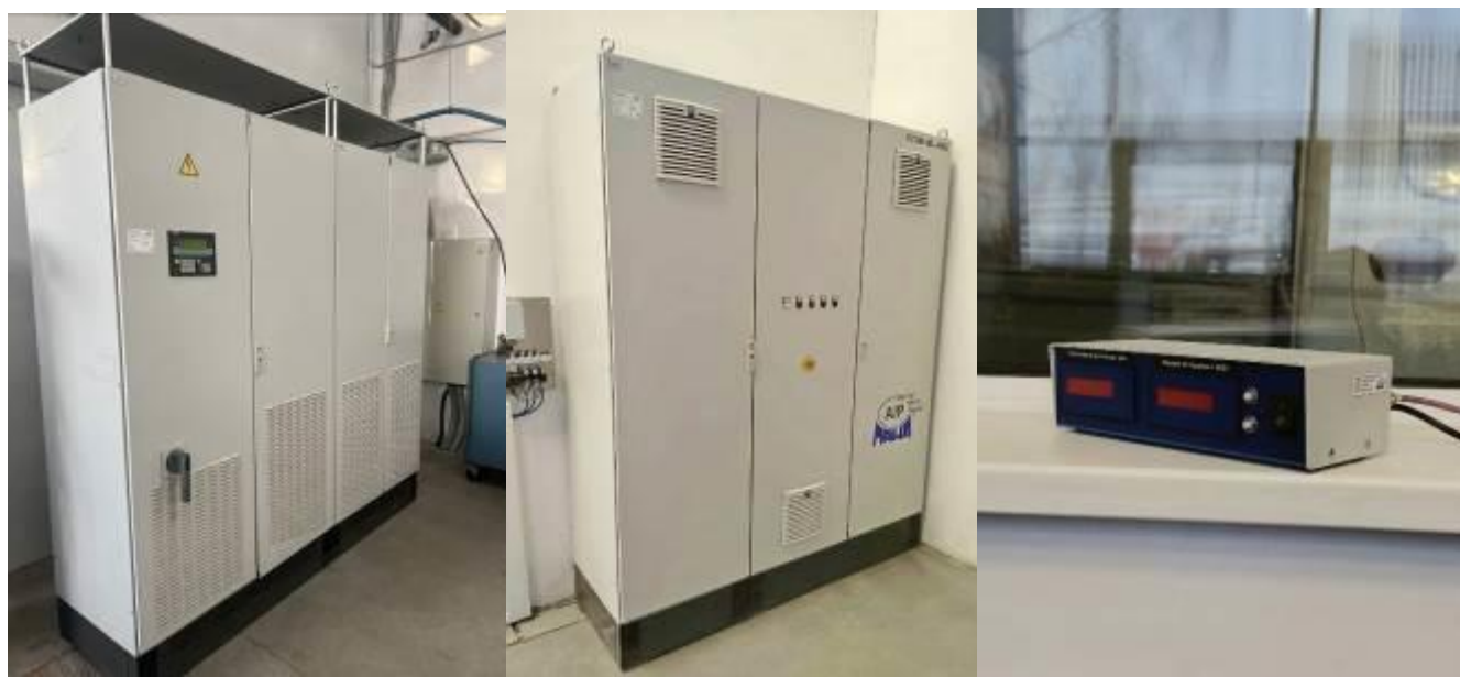
Рисунок 2 – Общий вид стенда (силового электрошкафа, электрошкафа управления, блока измерений частоты)
