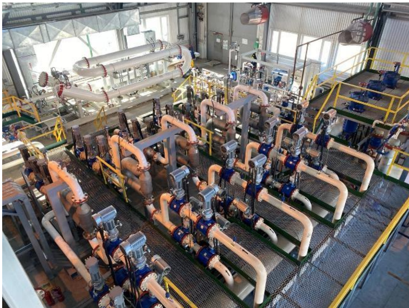
Рисунок 1 – Общий вид СИКН
