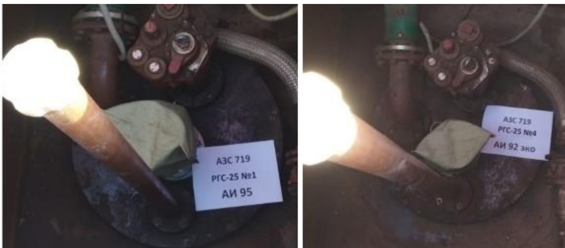
Рисунок 4 – Горловины резервуаров РГС-25 зав.№№ 1, 4
