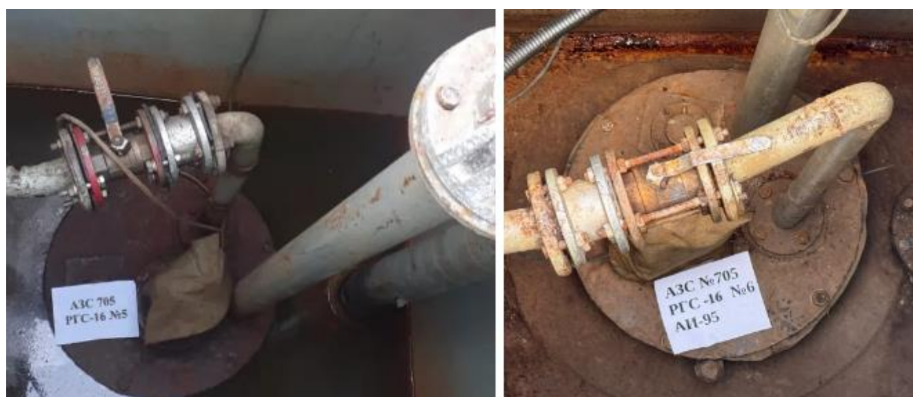
Рисунок 5 – Горловины резервуаров РГС-16 зав.№№ 5, 6
