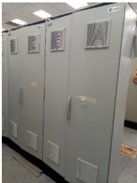
Рисунок 1 – Общий вид контроллерных шкафов
