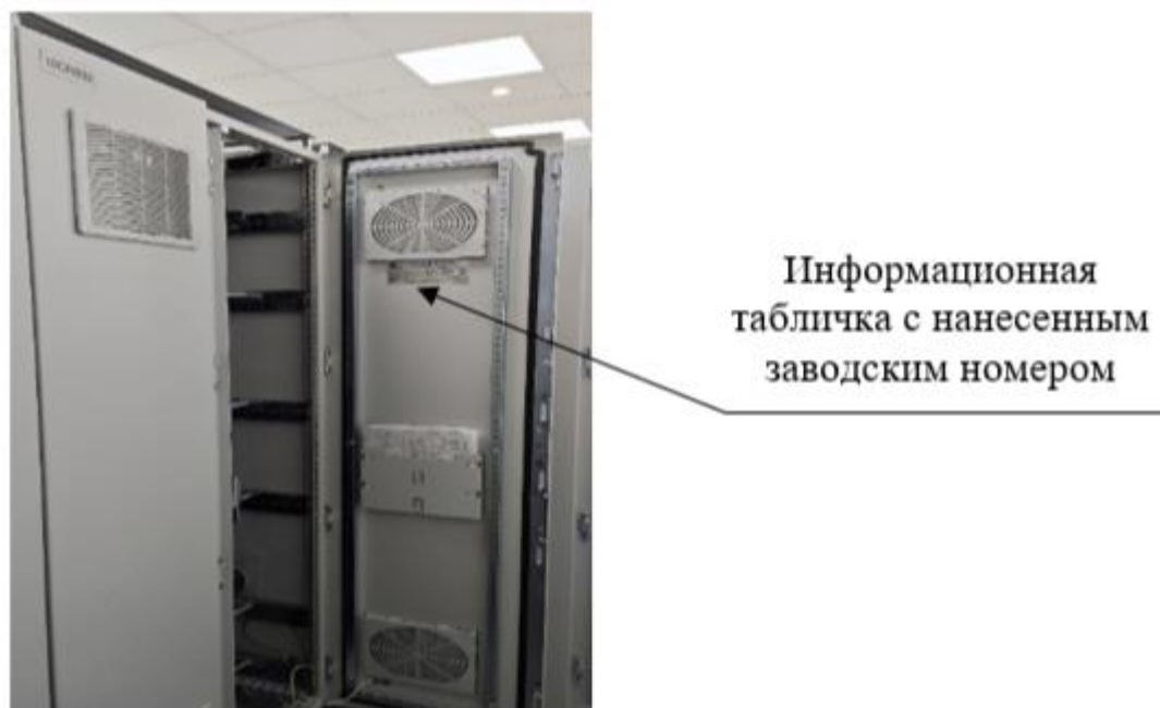
Рисунок 2 – Общий вид контроллерных шкафов с указанием места нанесения информационной таблички
