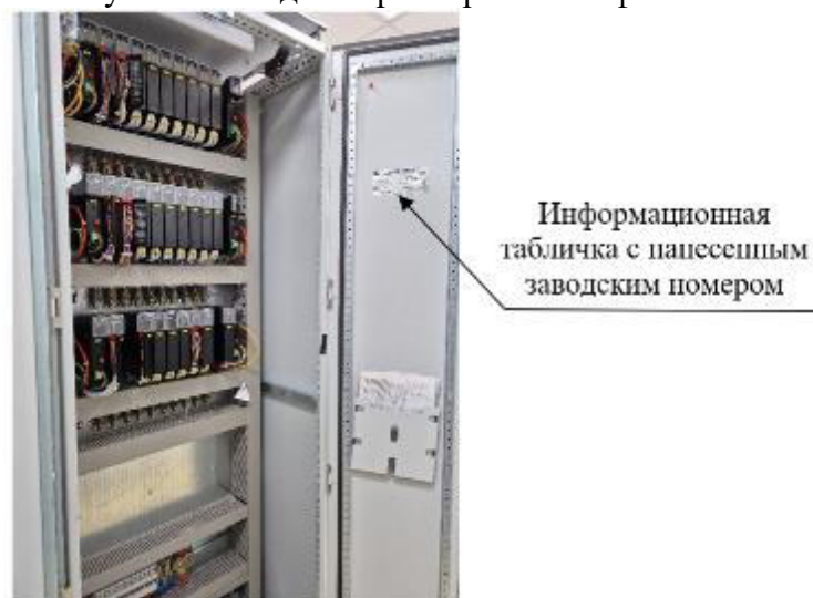
Рисунок 2 – Вид контроллерных шкафов «Regul»
