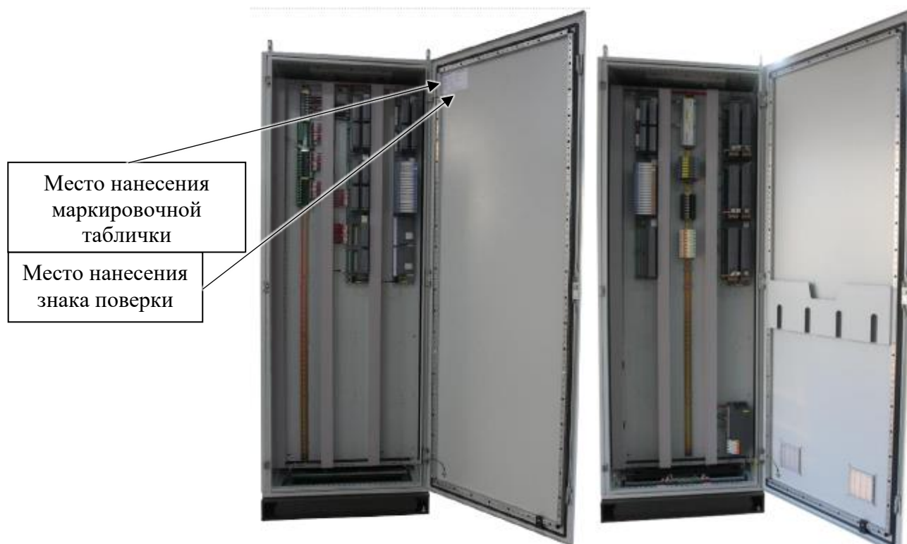
Рисунок 2 – Общий вид шкафа спереди и сзади
