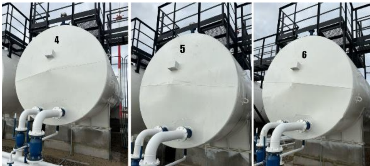
Рисунок 2 – Общий вид резервуаров РГС-50 с зав. №№ 4, 5, 6
