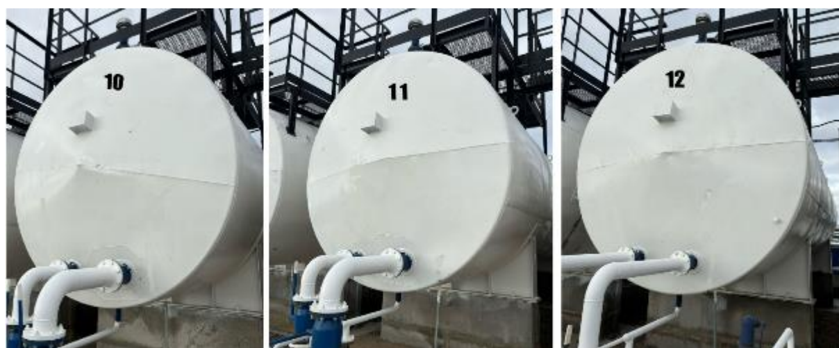
Рисунок 4 – Общий вид резервуаров РГС-50 с зав. №№ 10, 11, 12
