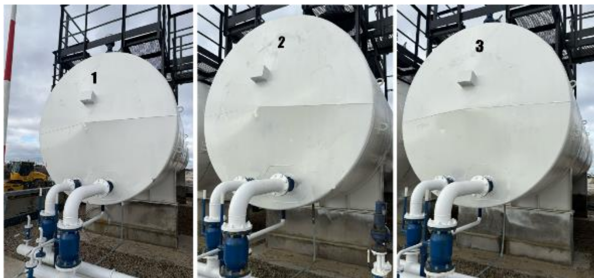
Рисунок 1 – Общий вид резервуаров РГС-50 с зав. №№ 1, 2, 3
