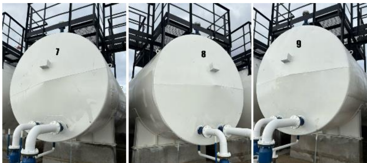
Рисунок 3 – Общий вид резервуаров РГС-50 с зав. №№ 7, 8, 9
