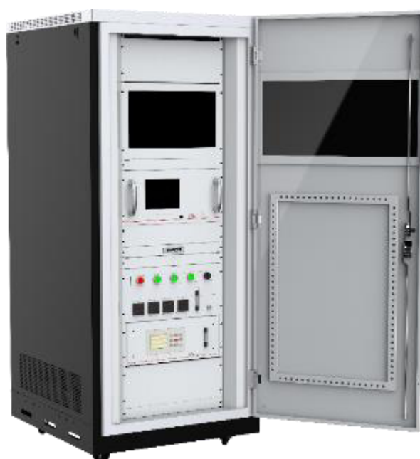
Рисунок 2 – Общий вид системы газоаналитической NLE-FT с открытой дверью
