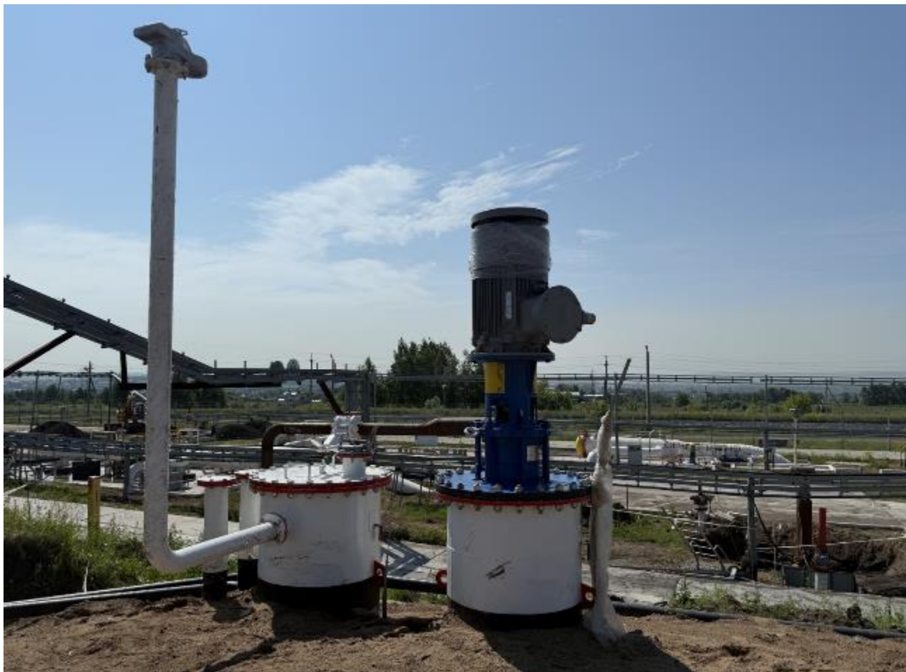
Рисунок 3 – Горловины и измерительный люк резервуара ЕП-12,5-2000-1500-А-С-У1 зав.№ 390
